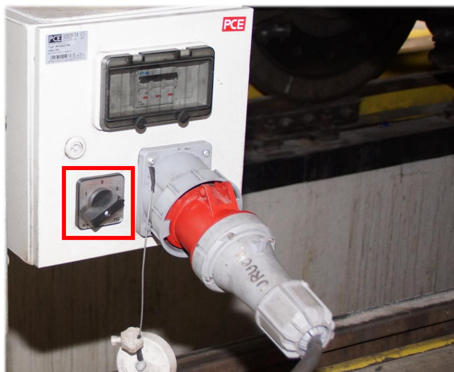
Rysunek 137. Widok skrzynki zasilania zewnętrznego i przełącznika kolejności faz
