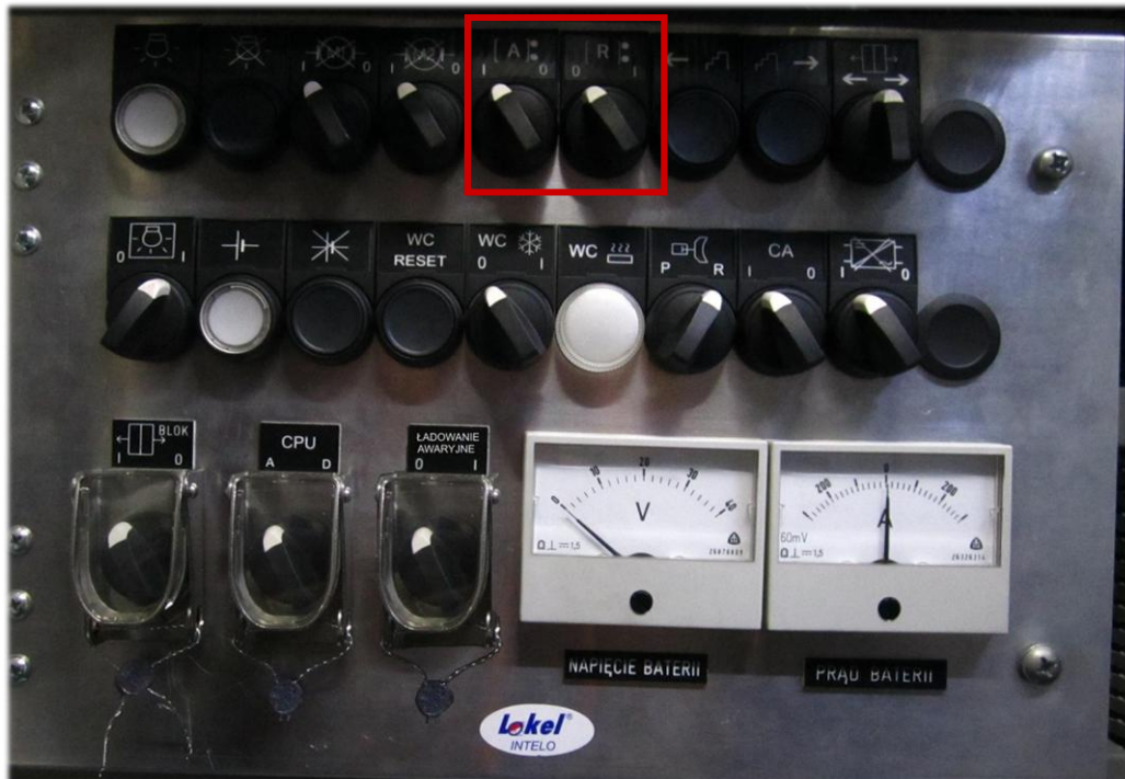
Rysunek 42. Widok panelu szafy SE
