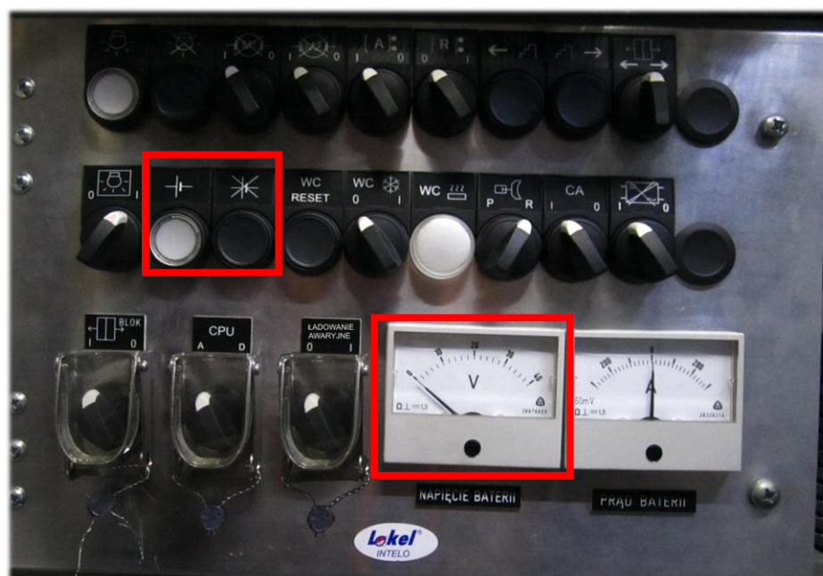
Rysunek 142. Widok przycisków załączenia i wyłączenia baterii akumulatorów oraz woltomierza
